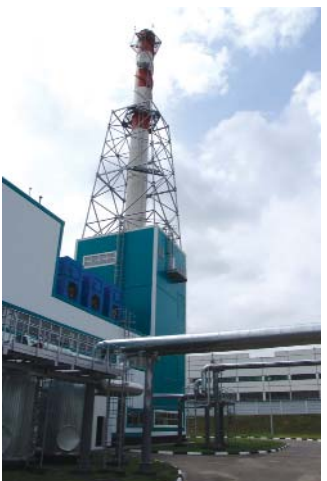
ТЭЦ «Луч» обладает самым современным оборудованием и технологическими системами
