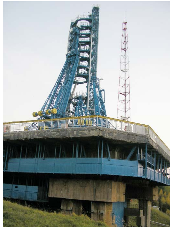
Стартовый комплекс, на котором специалистами ОАО ЦНПО «Каскад» осуществлялись работы по восстановлению лакокрасочного покрытия
