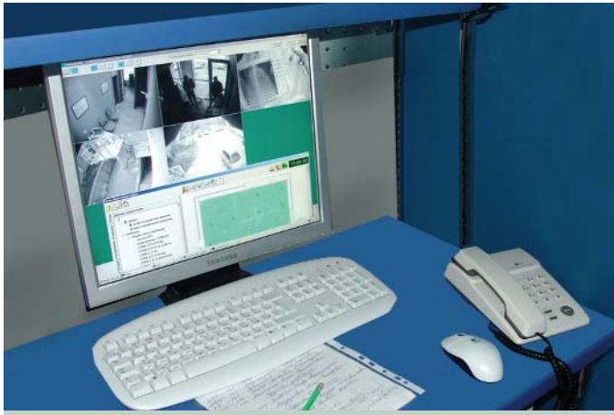
Рабочее место оператора охранной системы
