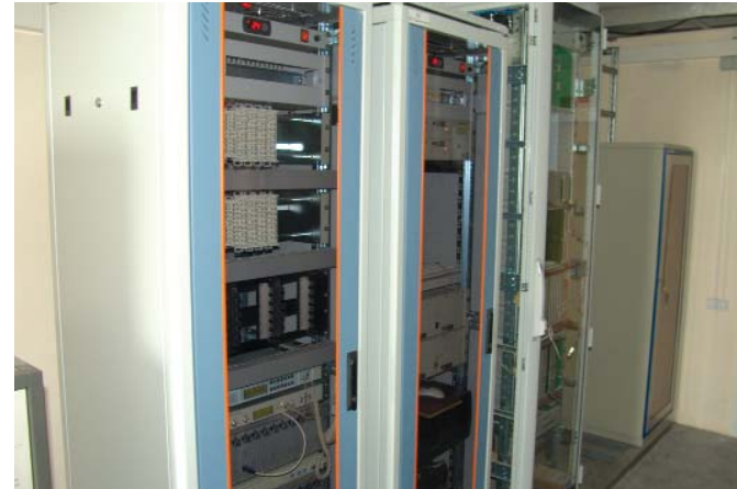
Системы оптоволоконной и радиорелейной связи, установленные силами ОАО ЦНПО «КАСКАД» на объекте
