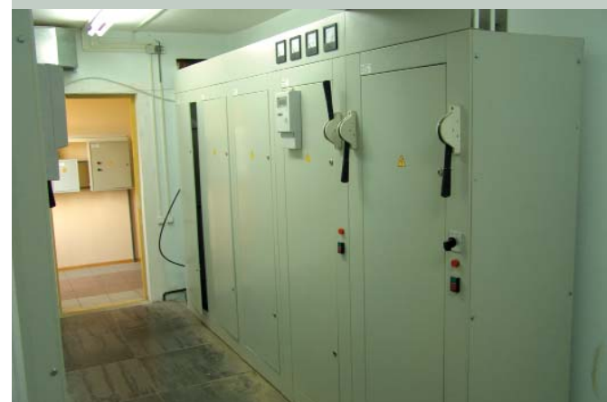
Главный распределительный щит
