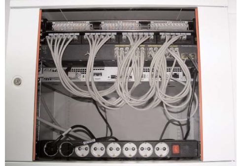
Телекоммуникационный шкаф с оборудованием: сетевой коммутатор второго уровня Cisco Catalyst 2960, голосовой шлюз для подключения аналоговых телефонных аппаратов и факсов Cisco VG224
