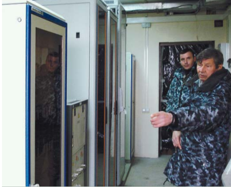
Один из старейших сотрудников Пятигорского филиала ОАО ЦНПО «КАСКАД» Дмитрий Федорович Канышин ведет обзор оборудования, смонтированного на объекте ЮТК
