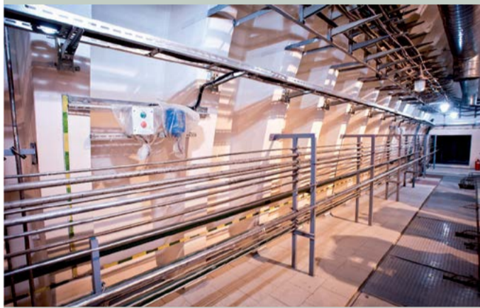
Кабельные сети, проложенные ПАО ЦНПО «КАСКАД» в здании заправочно-нейтрализационного комплекса (космодром «Восточный»)
